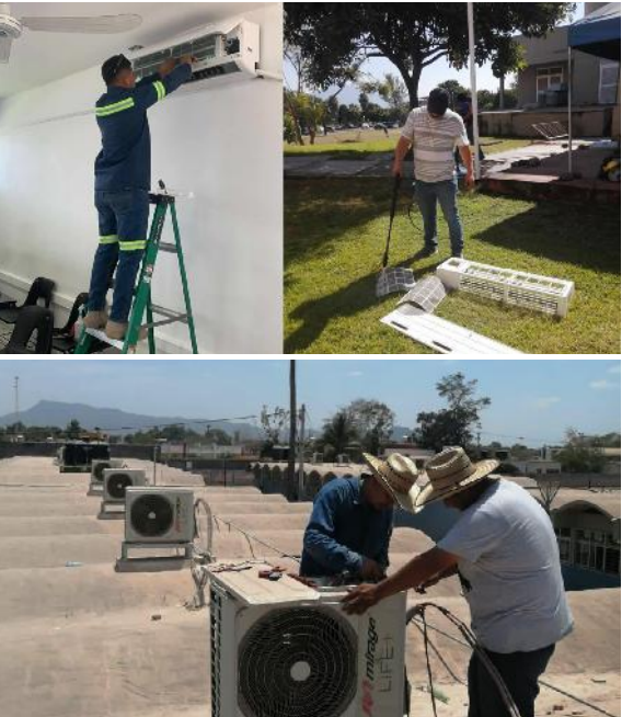
Mantenimiento de aires acondicionados
